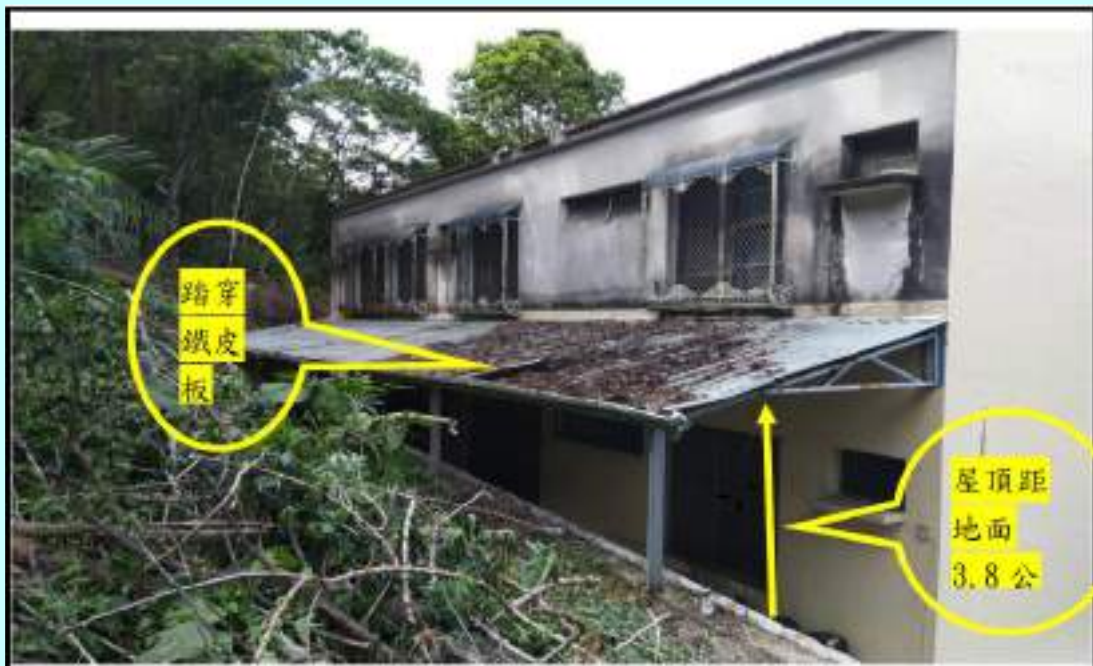
照片 1 屋頂（未設置護欄未設置安全母索及未設寬 30 公分以上踏板）踏穿鐵皮板
